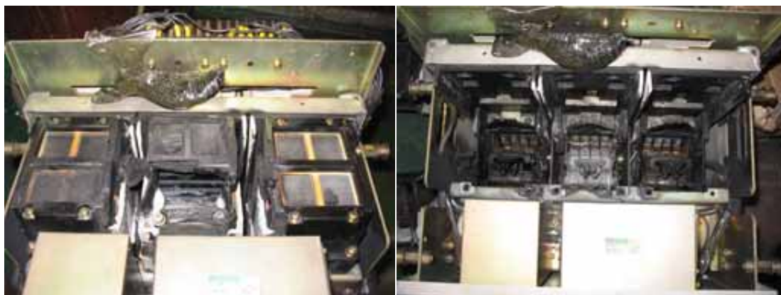
Kuva 3 ja 4. Palanut virrankatkaisijan kotelo keskellä.
